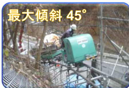
■ 工事用モノレール
