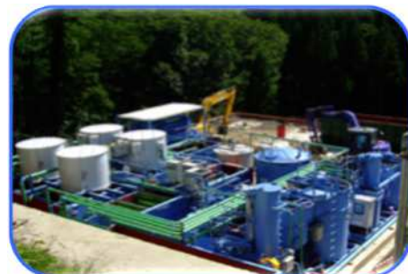
■ 濁水プラント
