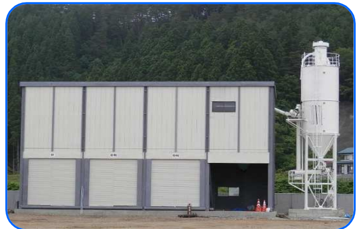
■バッチャープラント
